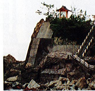
写真8 高知港海岸局部改良 (工事後)〔1. 高知新港建設事務所, 2. 四国開発・太陽工業, 3. 光コンクリート工業〕
